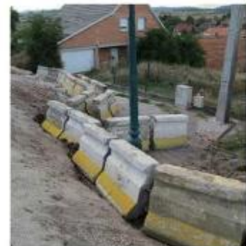
Photo n°3 : Dispositif de lutte contre le ruissellement
