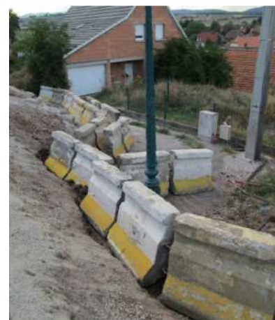
Photo n°3 : Dispositif de lutte contre le ruissellement
