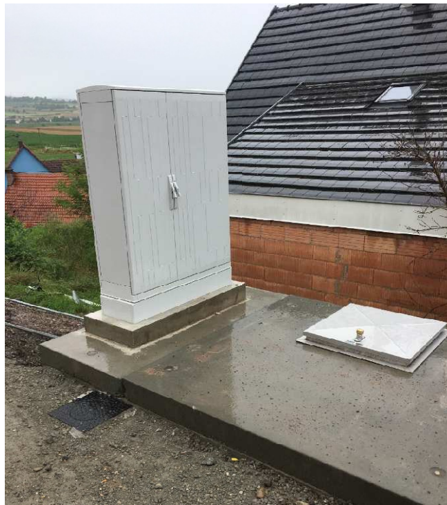
Photo n°2 : Armoire de contrôle du pilote
