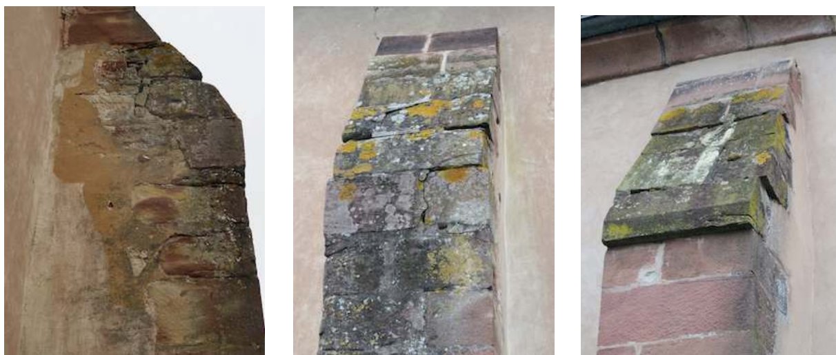
Contreforts sud : joints manquants sur les glacis ; coulures et dégradations de l'enduit
